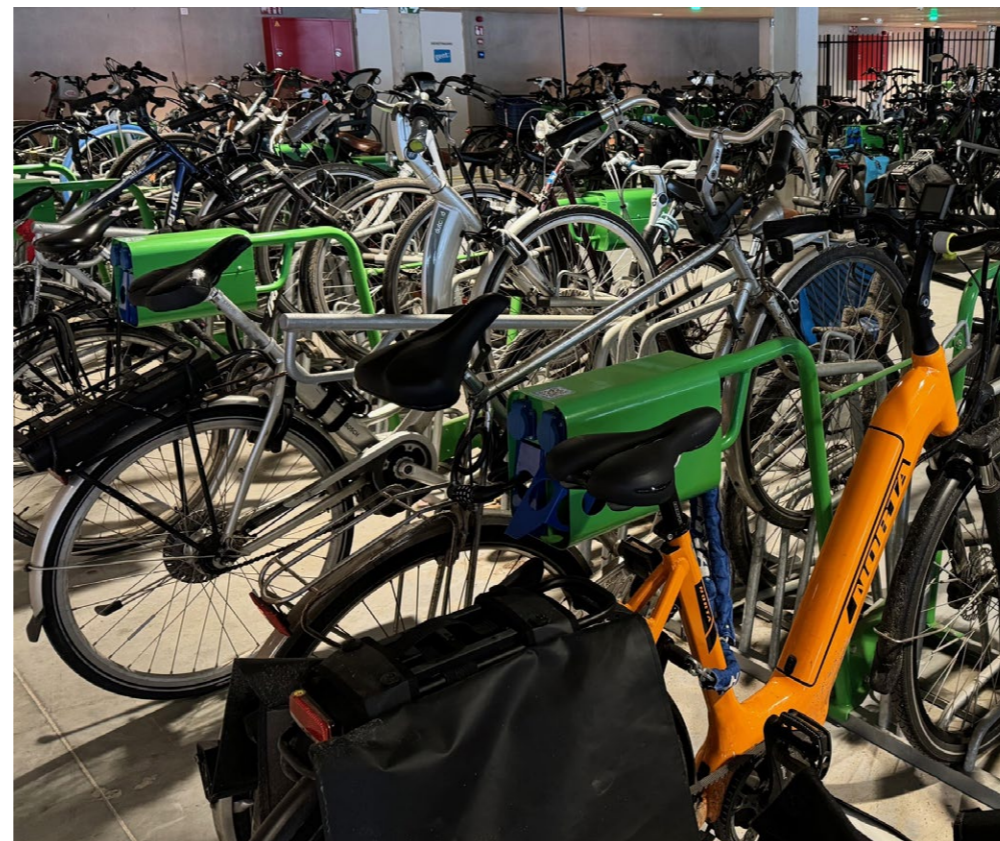
Oplaadpunten in fietsenstalling
